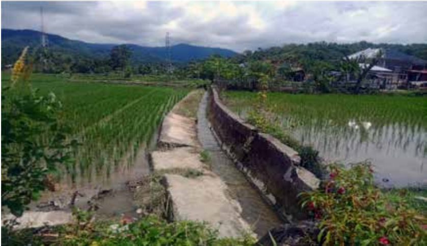
Gambar 7. Kerusakan Saluran Irigasi Tersier di Gampong Mata Ie, Aceh Barat Daya (Ilustrasi)
