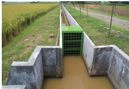
Gambar 40. Filter inlet outlet (FIO) yang berisi karbon aktif, penyaring residu pestisida
