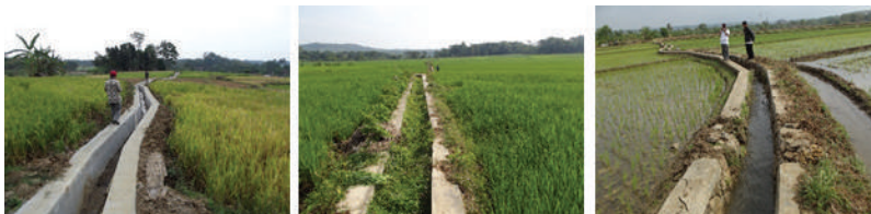
Gambar 1. Pemelesteran/Pembangunan Saluran Irigasi Baru, Saluran Irigasi Penuh Sedimen dan Saluran Irigasi Rusak di kabupaten Cirebon.
